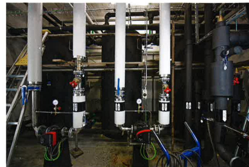
Akkumulatorerna för kyla rymmer sammanlagt 15 kubikmeter.
